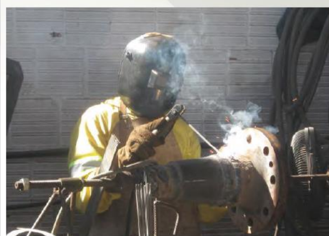
Colaborador executando atividade em oficina de solda do canteiro central de obras, utilizado EP's adequados para a atividade.
