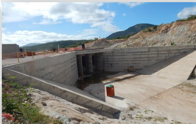
Estrutura de controle Res. Porcos.
