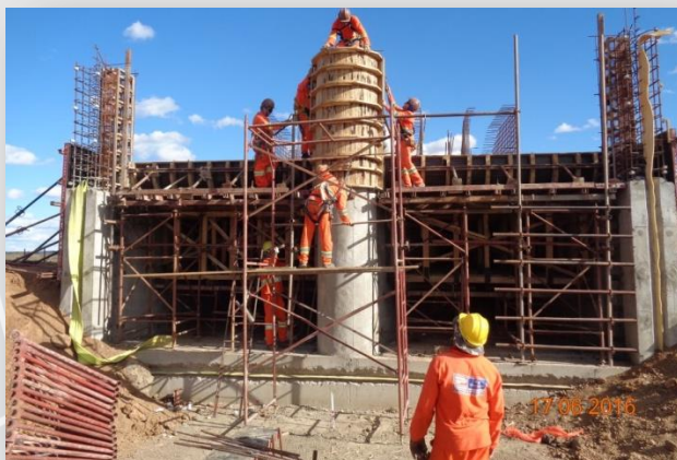
Estação de bombeamento EBV-5
