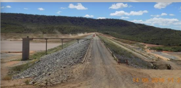
Reservatório Boa Vista
