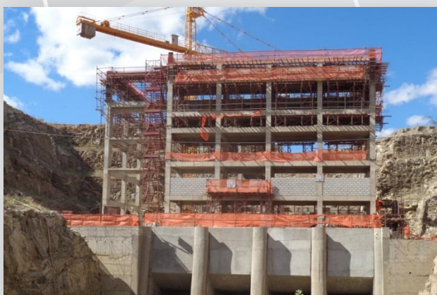
Estação de bombeamento EBV-6
