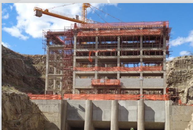
Estação de bombeamento EBV-6
