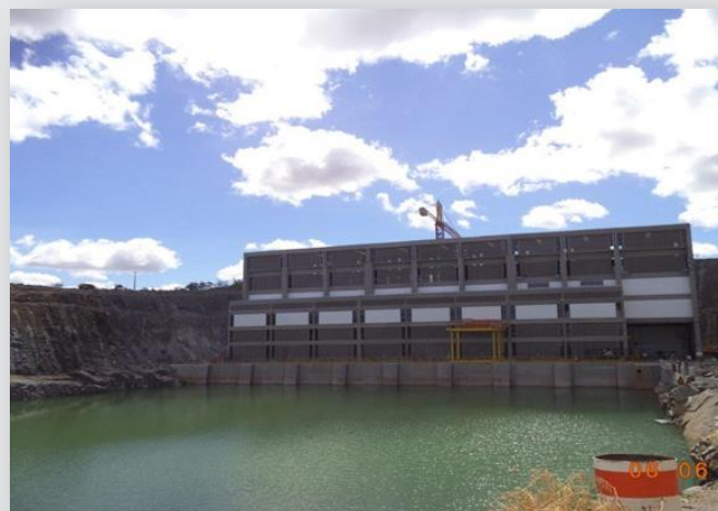
Estação de bombeamento EBI-2
