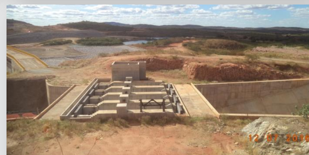
Estrutura de Controle Reservatório Caiçara
