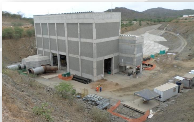
Estação de Bombeamento EBV-4.
