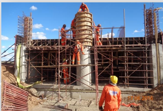
Estação de bombeamento EBV-5
