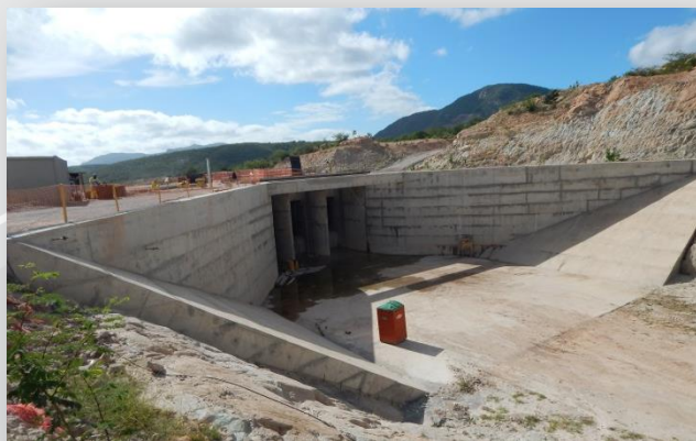
Estrutura de controle Res. Porcos.
