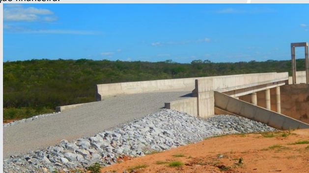
Reservatório Barro Branco
