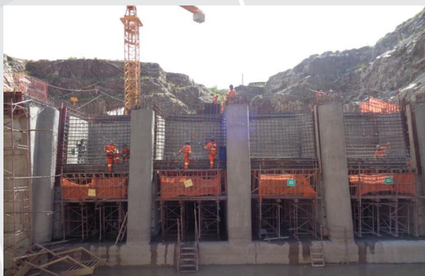
Estação de bombeamento EBV-6
