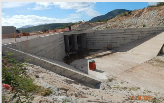
Estrutura de controle Res. Porcos.
