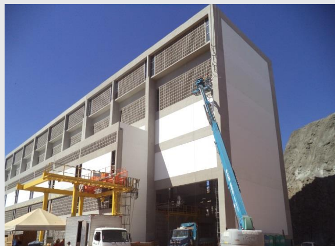
Estação de bombeamento EBI-2
