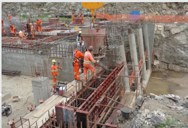
Estação de bombeamento EBV-5
