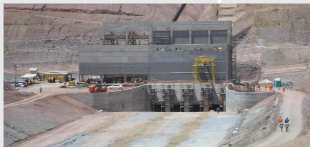
Estação de Bombeamento EBV-3
