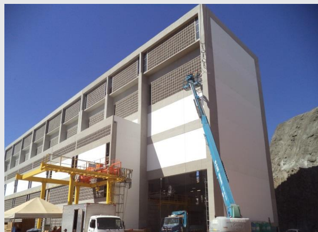
Estação de bombeamento EBI-2
