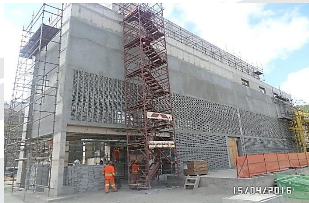
Estação de Bombeamento EBV-4.
