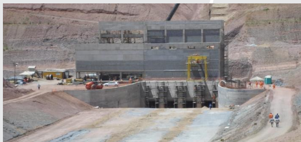
Estação de Bombeamento EBV-3
