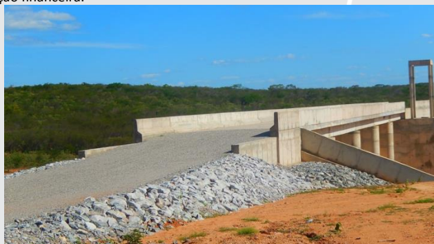
Reservatório Barro Branco
