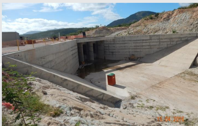
Estrutura de controle Res. Porcos.
