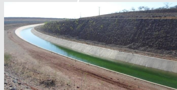
Canal entre EBV-1 e Res. Areias
