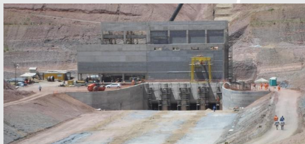
Estação de Bombeamento EBV-3
