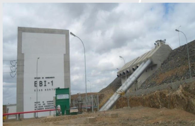
Estação de bombeamento EBI-1 em funcionamento.
