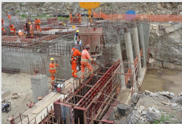
Estação de bombeamento EBV-5
