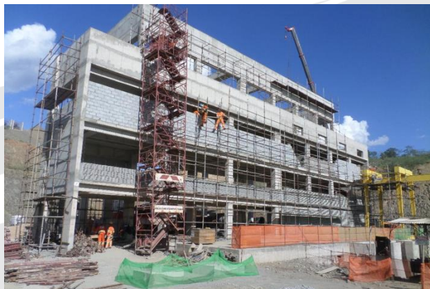
Estação de Bombeamento EBV-4.
