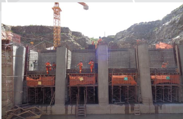
Estação de bombeamento EBV-6
