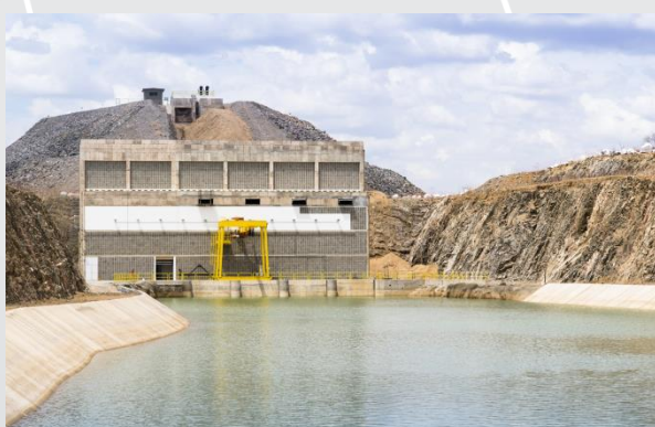
Estação de bombeamento EBV-2.
