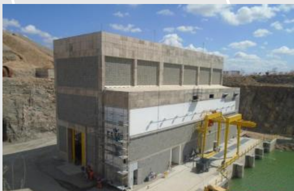
Estação de bombeamento EBV-2.
