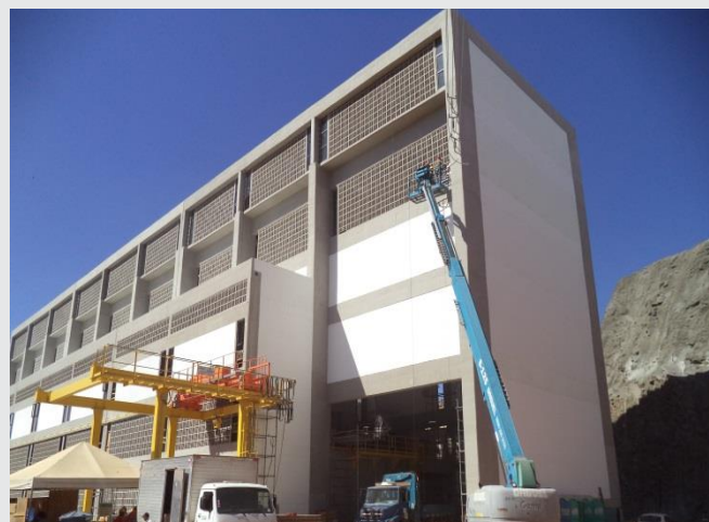
Estação de bombeamento EBI-2
