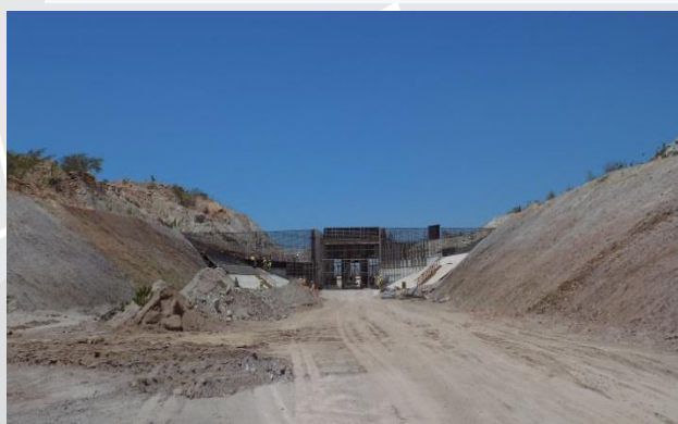
Estrutura de controle Res. Porcos.
