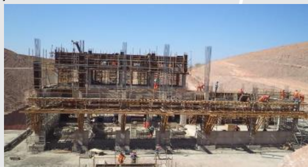
Estação de Bombeamento EBV-3
