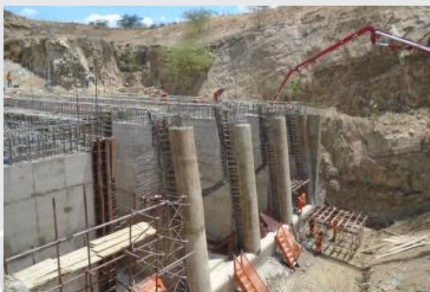
Estação de bombeamento EBV-5
