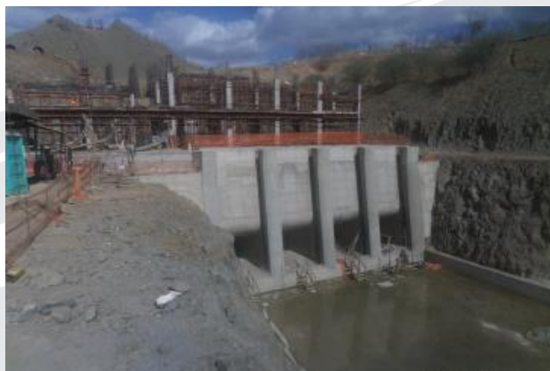
Estação de Bombeamento EBV-4.
