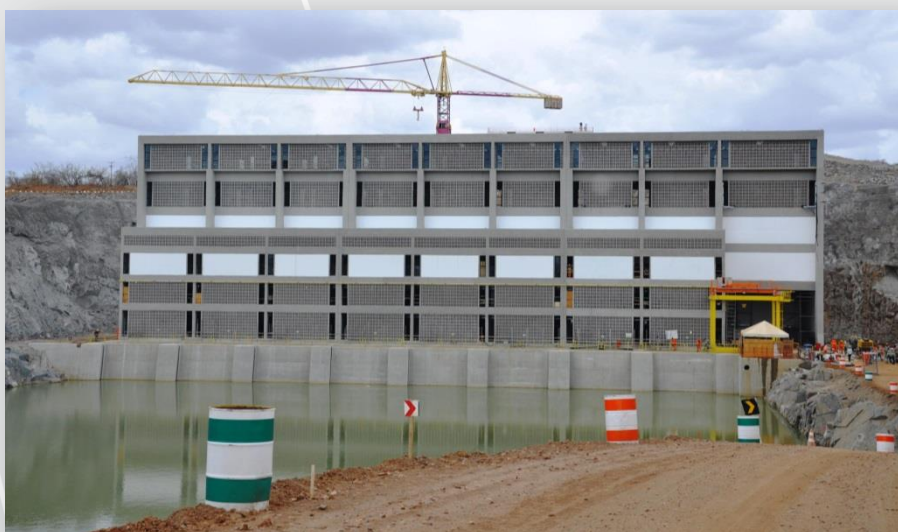
Estação de Bombeamento EBI-2
