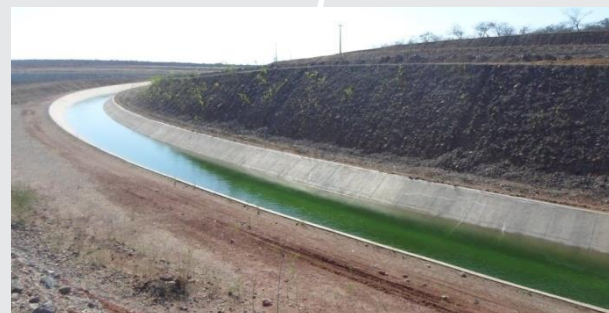
Canal entre EBV-1 e Res. Areias
