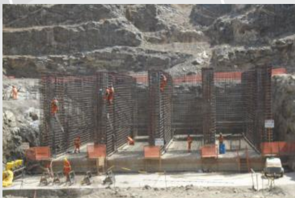
Estação de bombeamento EBV-6
