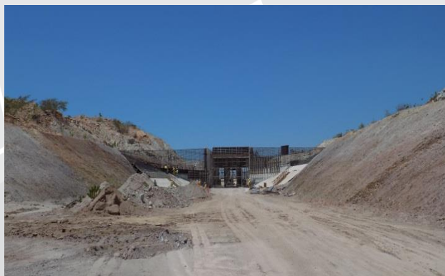
Estrutura de controle Res. Porcos.
