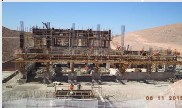
Estação de Bombeamento EBV-3
