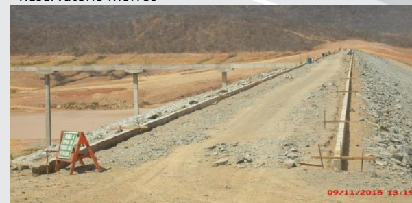
Reservatório Boa Vista
