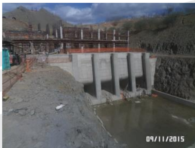
Estação de Bombeamento EBV-4.
