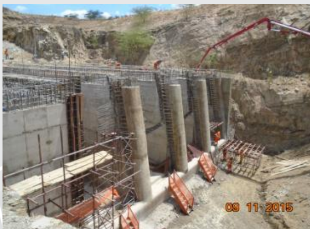
Estação de bombeamento EBV-5
