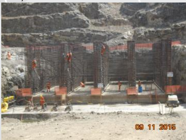
Estação de bombeamento EBV-6
