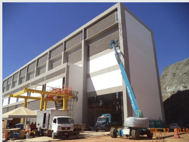
Estação de bombeamento EBI-2
