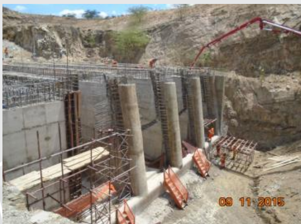
Estação de bombeamento EBV-5
