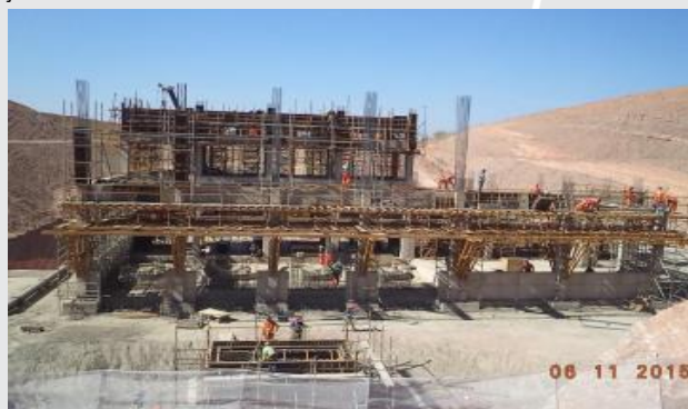
Estação de Bombeamento EBV-3
