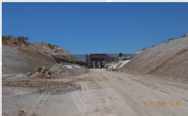
Estrutura de controle Res. Porcos.
