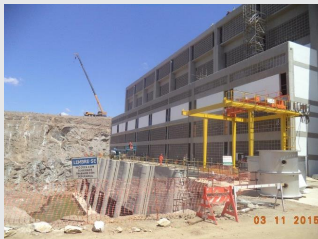
Estação de bombeamento EBI-2
