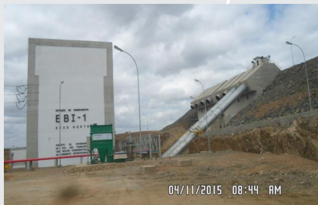
Estação de bombeamento EBI-1 em funcionamento.
