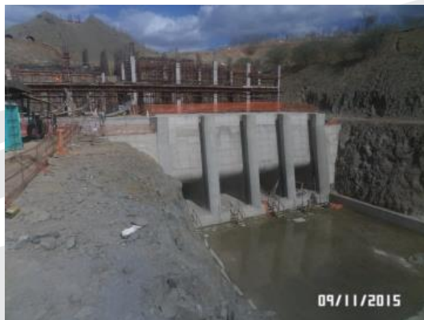
Estação de Bombeamento EBV-4.
