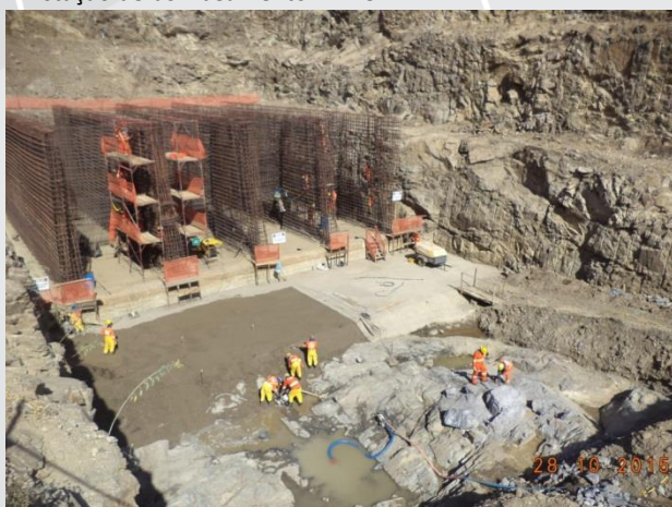
Estação de bombeamento EBV-6
