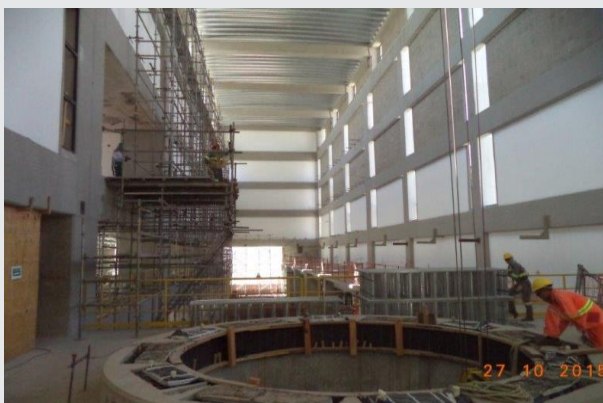
Interior da Estação de bombeamento EBI-2
