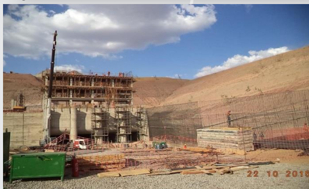
Estação de Bombeamento EBV-3
