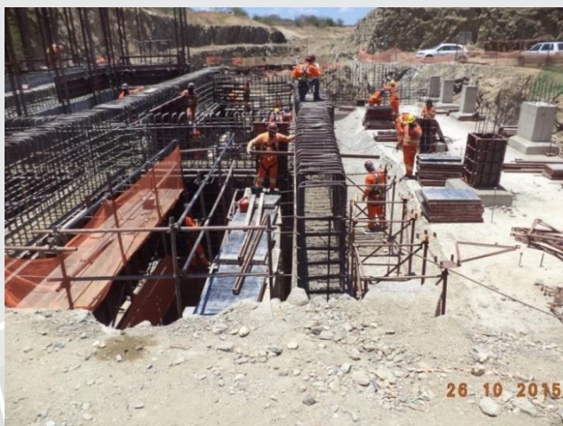
Estação de bombeamento EBV-5
