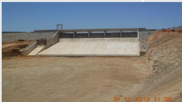
Reservatório Barro Branco
