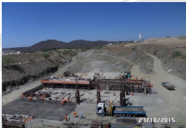
Estação de Bombeamento EBV-4.
