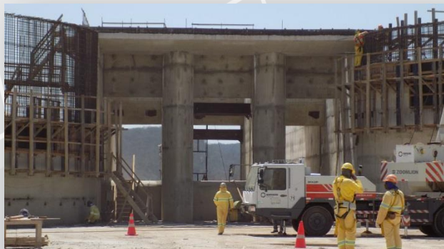
Estrutura de controle Res. Porcos.
