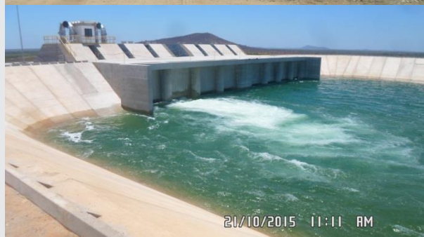
Estação de bombeamento EBI-1 em funcionamento.
