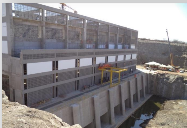
Estação de bombeamento EBI-2
