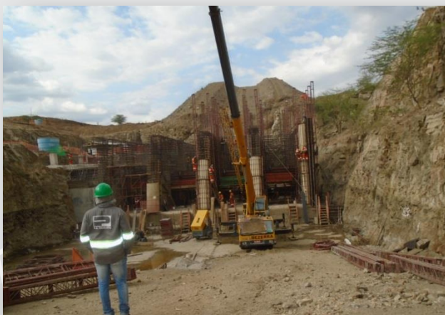
Estação de bombeamento EBV-5
