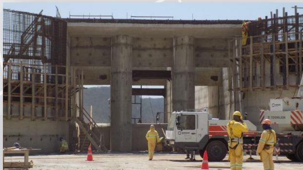
Estrutura de controle Res. Porcos.
