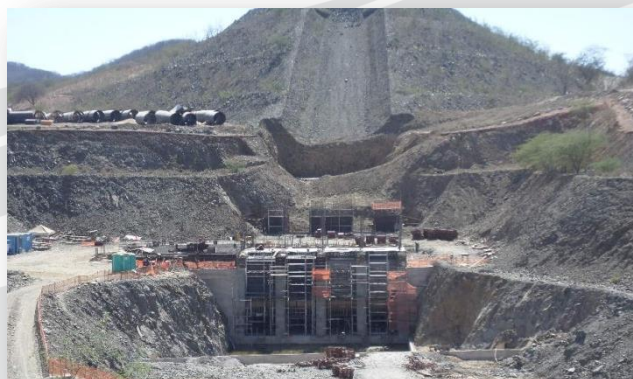
Estação de Bombeamento EBV-4.
