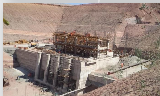
Estação de Bombeamento EBV-3
