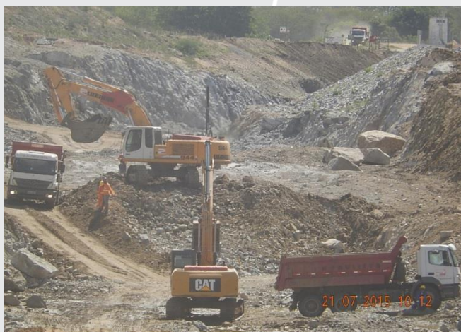
Segmento de Canal entre o Reservatório Barro Branco e o Túnel Engº Giancarlo Lins Cavalcanti
