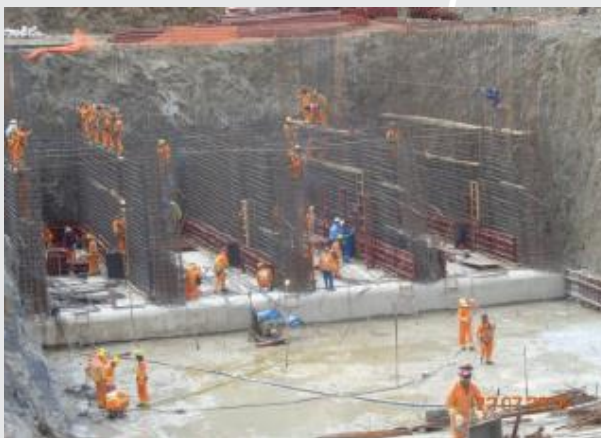
Estação de Bombeamento EBV-4
