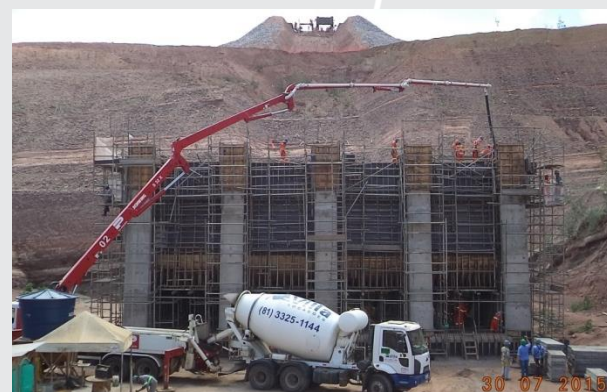
Estação de Bombeamento EBV-3
