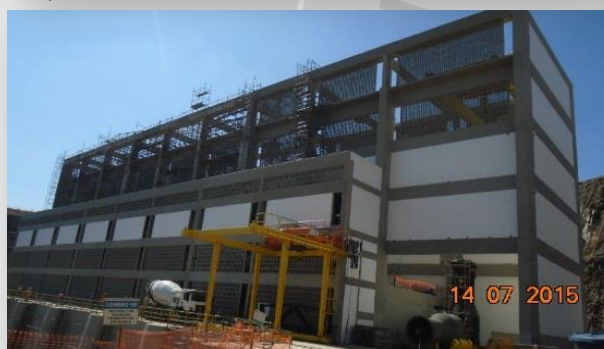
Estação de Bombeamento EBI - 2.
