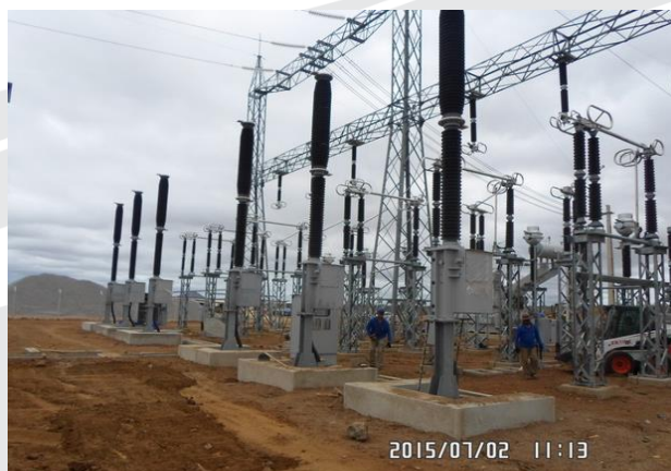
Subestação N2 da Estação de Bombeamento EBI-2
