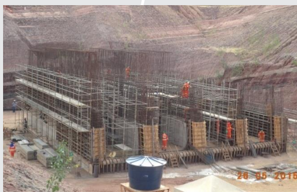
Estação de Bombeamento EBV-3
