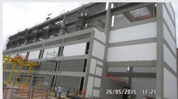
Estação de Bombeamento EBI - 2.
