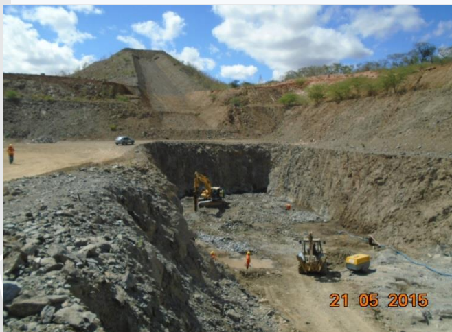
Estação de Bombeamento EBV-4
