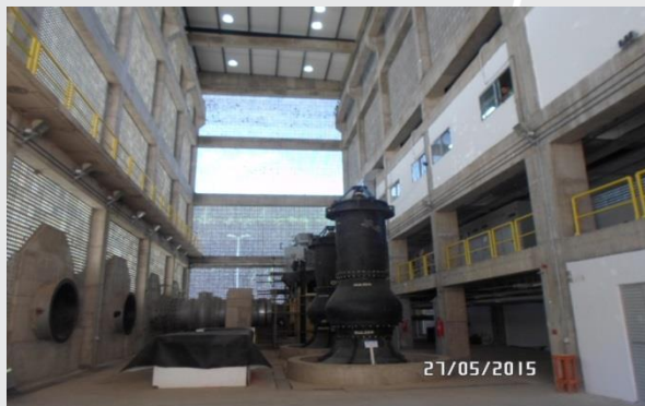
Interior da EBV-1. Bombas principais.
