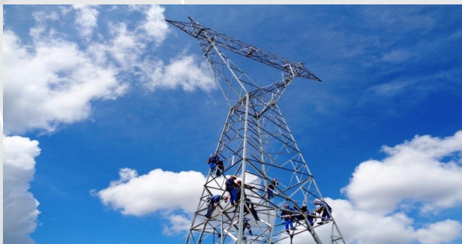
Execução da Linha de Transmissão do Eixo Norte estão em ritmo acelerado.
