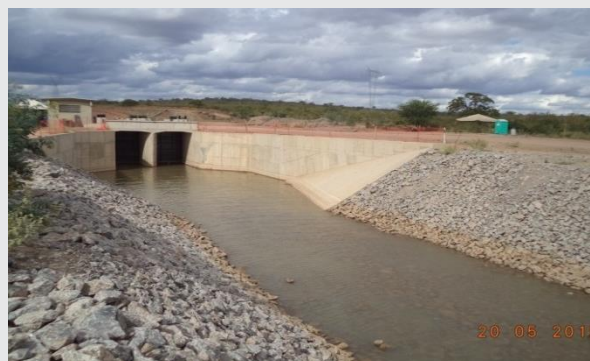
Estrutura de Controle do Res. Areias .
