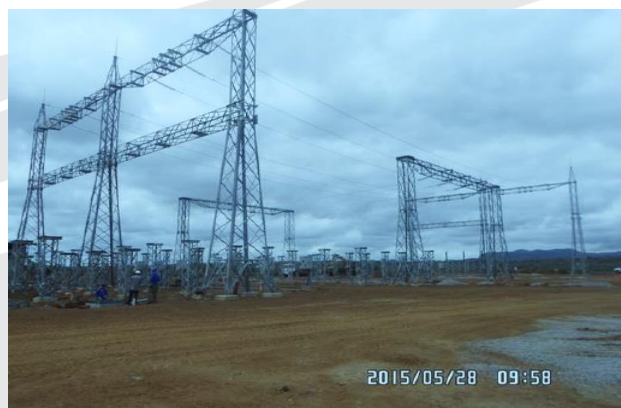
Subestação N2 da Estação de Bombeamento EBI-2
