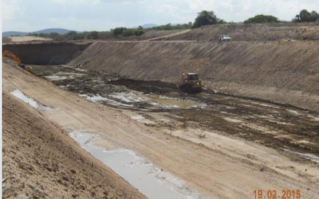
Segmento de Canal entre Túnel Eng. Giancarlo Lins Cavalcanti e Adutora Monteiro
