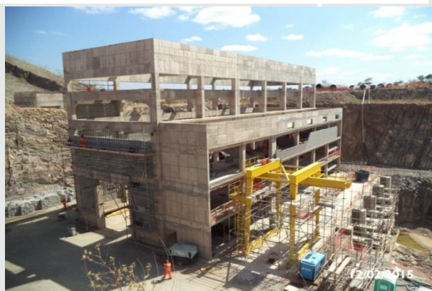
Estação de bombeamento EBV-2.
