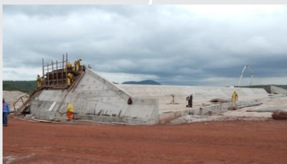
Reservatório Boi I
