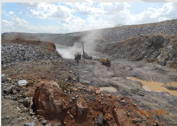
Segmento de Canal entre Res. Barro Branco e o do Túnel Eng. Giancarlo Lins Cavalcanti.
