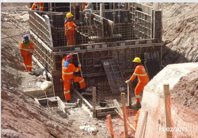
Tomada d'água de uso difuso da Barragem Salgueiro
