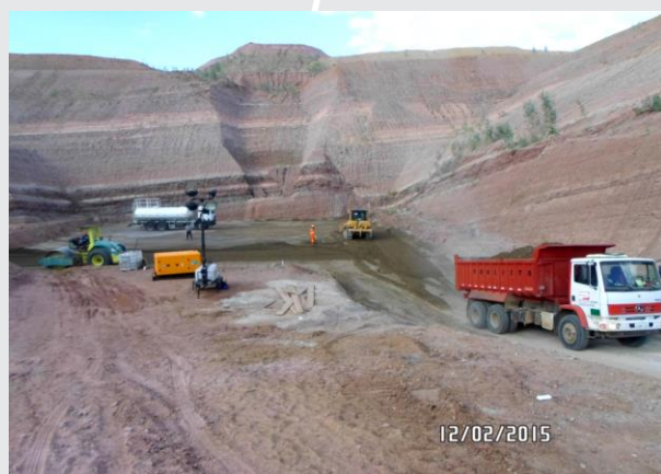
Estação de Bombeamento EBV-3
