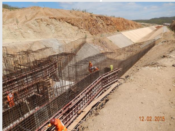
Estrutura de Controle do Reservatório Barro Branco.
