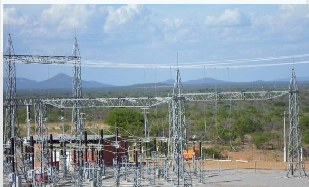
Subestação de energia N1
