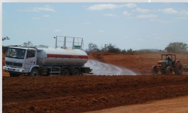
Reservatório Barro Branco
