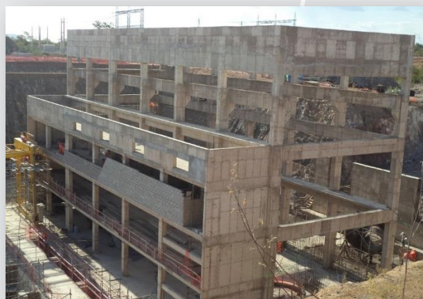
Estação de Bombeamento EBV-2.
