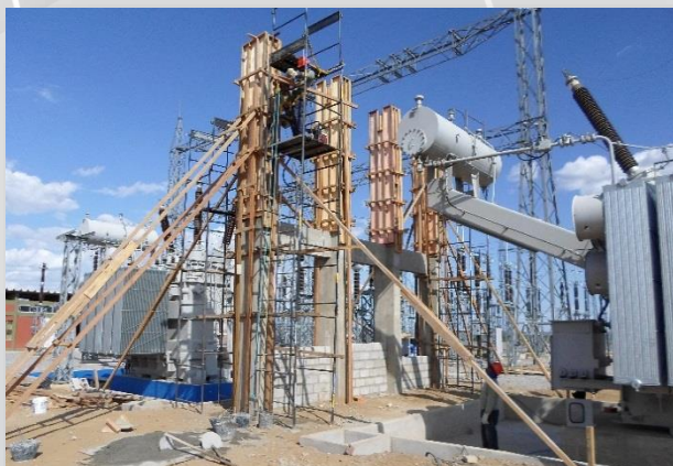
Subestação de energia N1.
