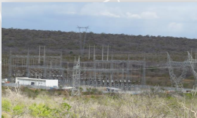
Subestação de Energia E0 – concluída e em operação.
