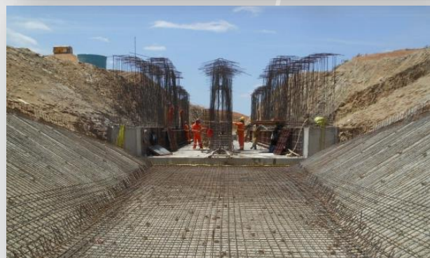
Estrutura de Controle do Reservatório Barro Branco.
