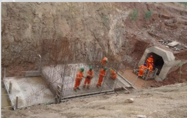
Tomada d'água de uso difuso da Barragem Salgueiro
