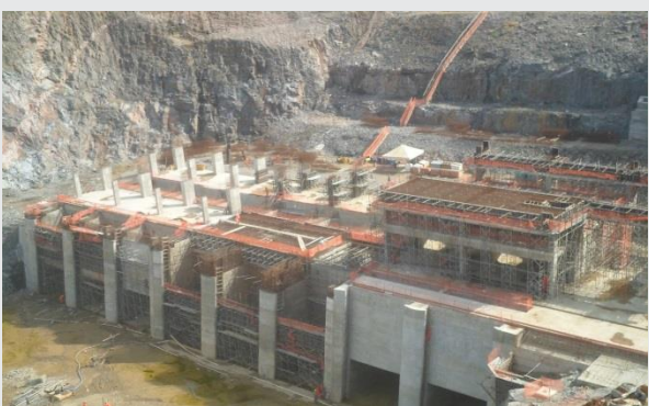
Estação de Bombeamento EBI-3
