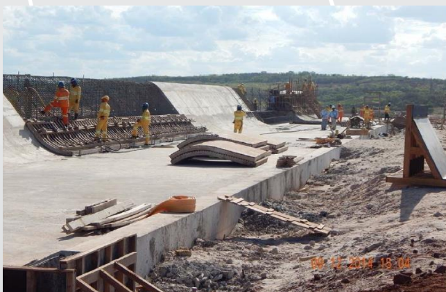
Reservatório Boi I.
