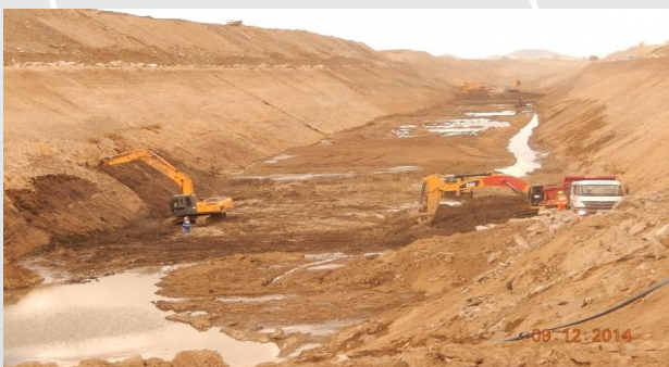
Segmento de Canal entre Túnel Eng. Giancarlo Lins Cavalcanti e Adutora Monteiro
