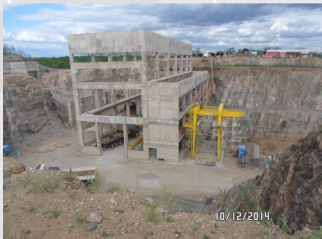
Estação de bombeamento EBV-2.
