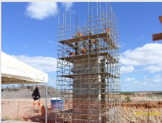
Tomada d'água de Salgueiro
