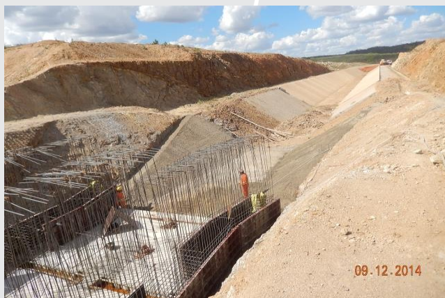
Estrutura de Controle do Reservatório Barro Branco.
