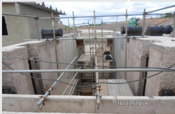
Estrutura de Controle do Reservatório Braúnas
