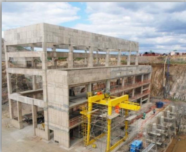
Estação de bombeamento EBV-2.
