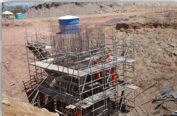
Tomada d'água de Salgueiro
