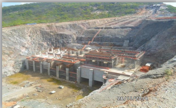
Estação de Bombeamento EBI-3
