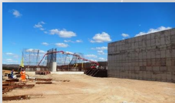
Reservatório Barro Branco: Ferragem tomada d'água
