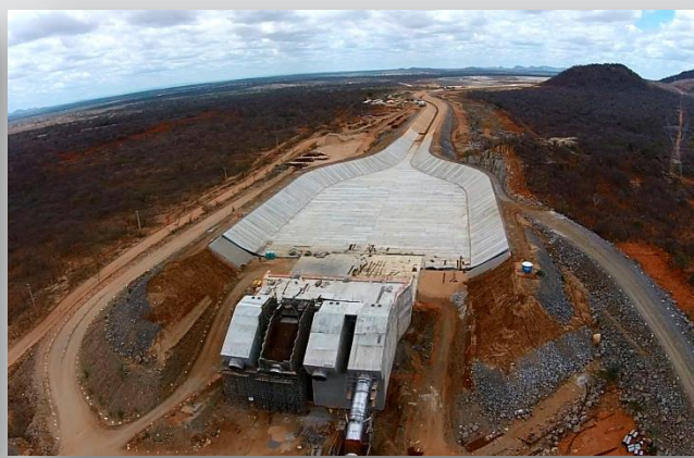
Forebay de jusante da EBI- 2
