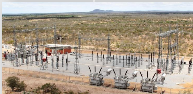
Subestação de energia da EBV-1.
