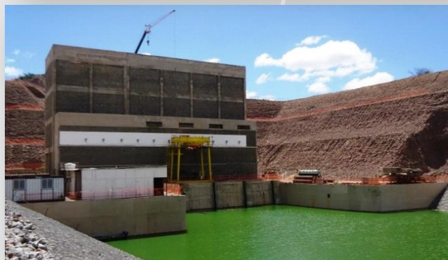
Estação de Bombeamento EBV-1.
