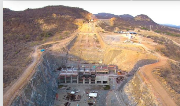
Estação de Bombeamento EBI-3
