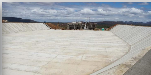
Forebay de jusante da EBI- 2
