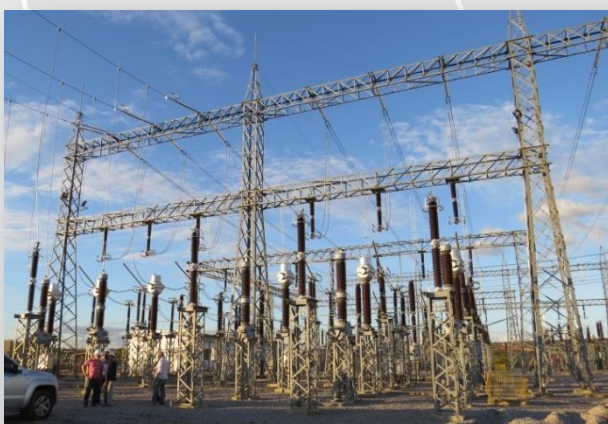
Subestação de energia E0.
