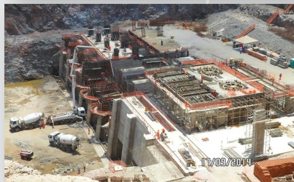
Estação de Bombeamento EBI-3
