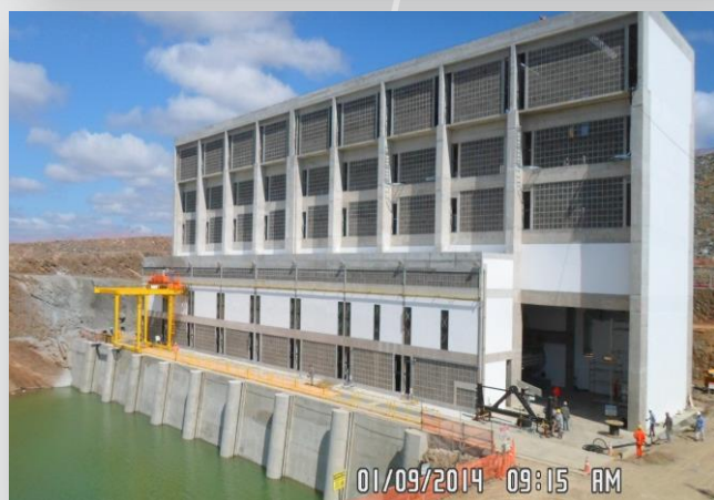
Estação de Bombeamento EBI-1.
