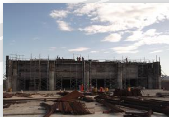
Estação de Bombeamento EBI-2
