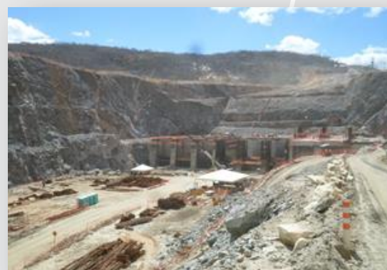
Estação de Bombeamento EBI-3
