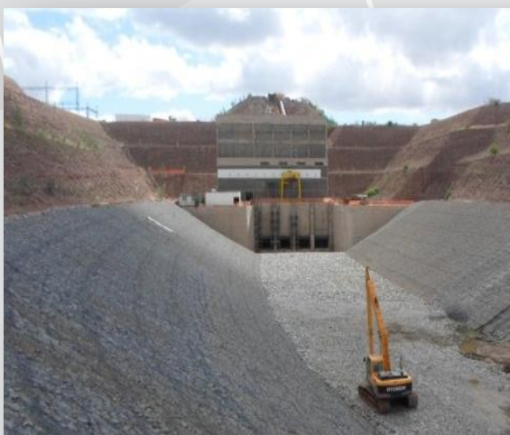
Estação de Bombeamento EBV-1.
