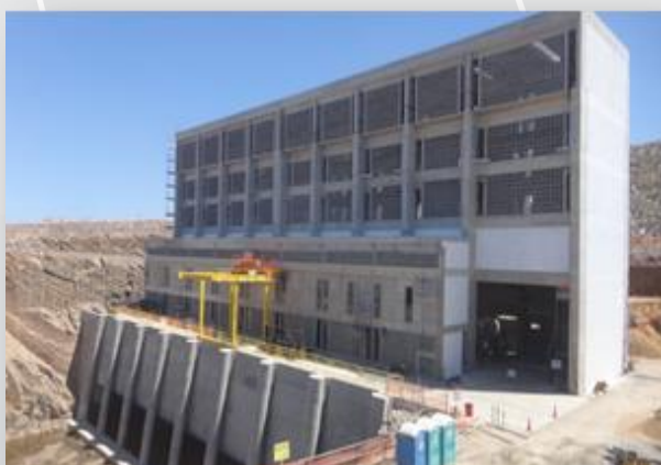
Estação de Bombeamento EBI-1.
