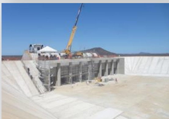
Forebay de jusante da EBI-1.
