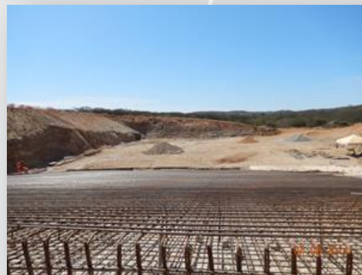
Reservatório Barro Branco: Ferragem tomada d'água
