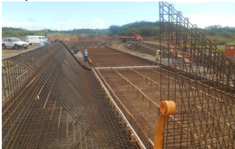
Reservatório de Morros: Montagem da armação e formas da lage, muro, ala e creager no vertedouro.
