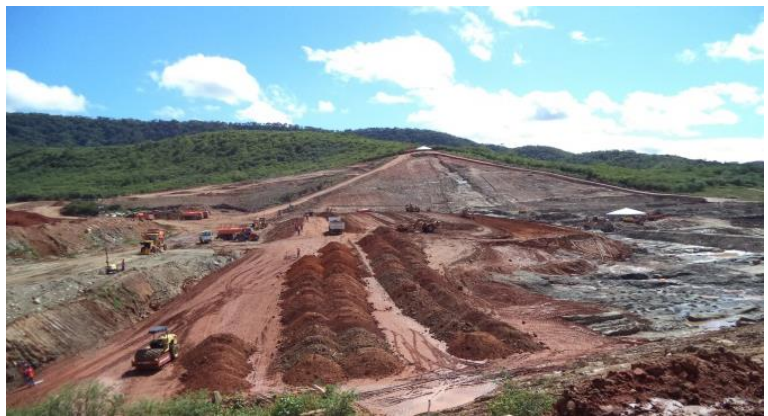
Reservatório Boa Vista: Vista geral da compactação do aterro no espaldar de montante.
