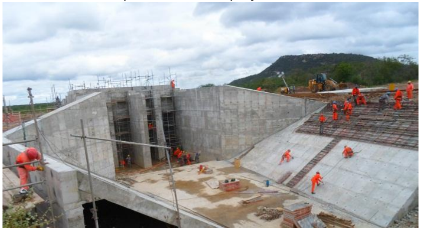
Estrutura de controle Tucutú - entrada da água no canal.
