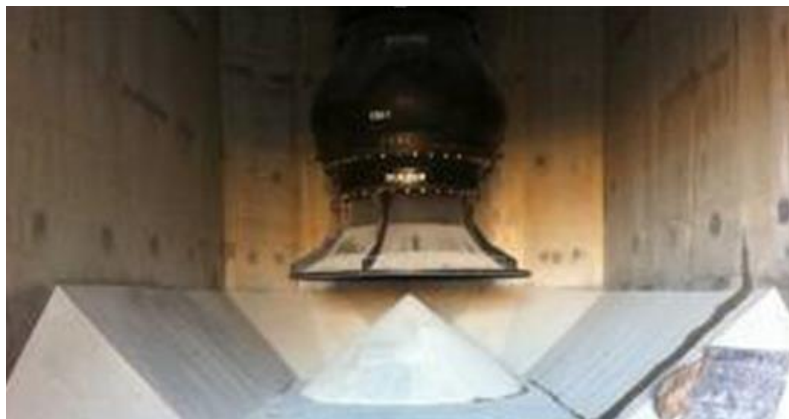
EBI-1 – Bombas instaladas no poço de sucção.
