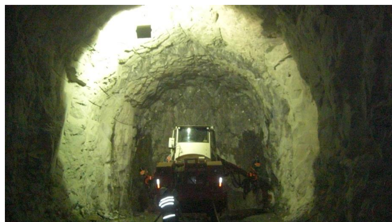
Túnel Cuncas I: em execução perfuração no sentido janela de acesso - emboque.
