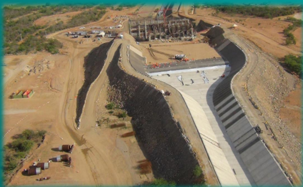
Estação de Bombeamento do Eixo Norte EBI-1 – Vista Geral
