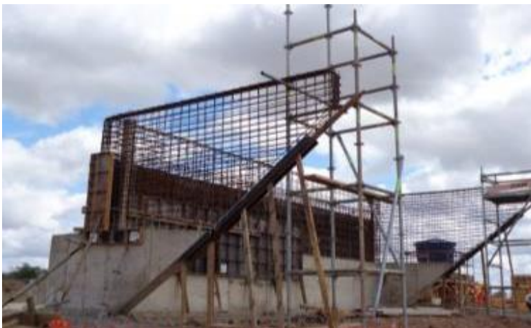
Ponte E-545+15,37: Execução da armadura da viga travessa nos pilares P2 e P4.
