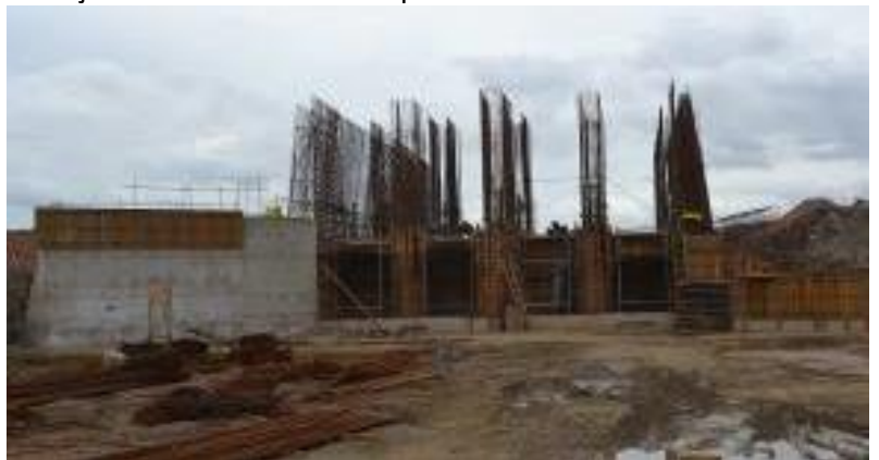
WBS 1158 – Estrutura de Controle de Serra do Livramento: Montagem de forma, armação e concretagem das paredes.
