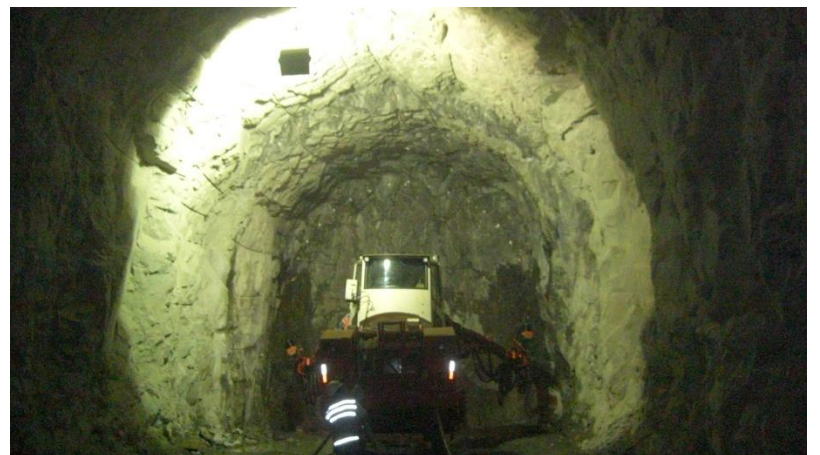
Túnel Cuncas I: em execução perfuração no sentido janela de acesso - emboque.
