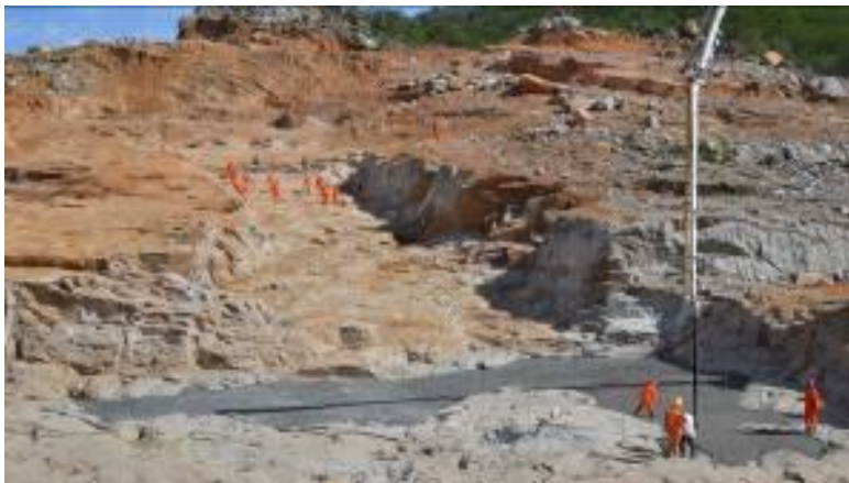
WBS 1109 – Reservatório Negreiros: Limpeza fina na ombreira esquerda e lançamento do concreto dental no barramento.
