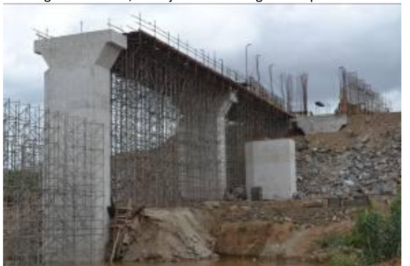
WBS 1309 – Aqueduto Salgueiro: Montagem do cimbramento, forma da laje de fundo e transição à montante.
