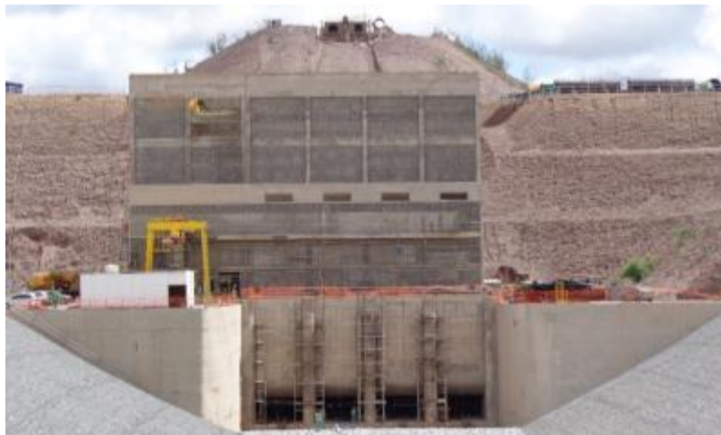
WBS 2610 - EBV-1: Vista frontal da primeira estação de bombeamento do Eixo Leste.
