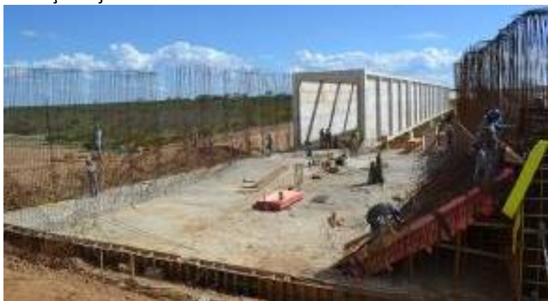
WBS 1306 - Aqueduto Saco da Serra: Montagem de forma, armação e concretagem das paredes da transição à montante.
