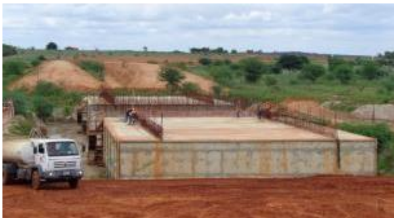
Bueiro Palha – Apicotamento do concreto.
