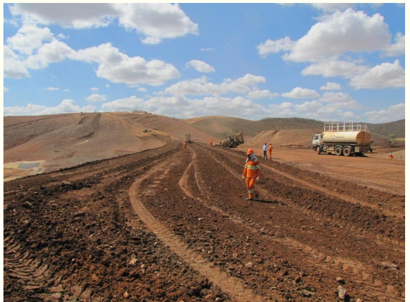
Barramento de Jati.
