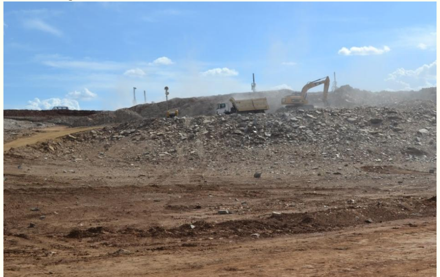
WBS 1106 - Reservatório Terra Nova - Escavação de material de 3ª categoria no vertedouro do reservatório Terra Nova
