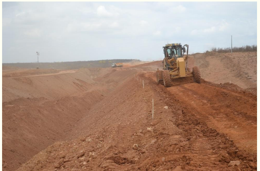
Segmento de canal -Homogeneização de aterro entre as estacas 5018 e 5028 no segmento de canal WBS-1219
