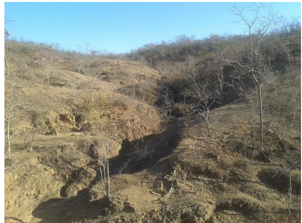
Foto 04 – Detalhe de processo erosivo iniciado pela exposição do solo e escoamento superficial ao longo dos anos na cabeceira do córrego.
