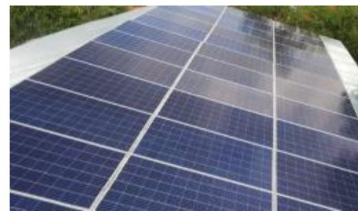
Usina Solar Fotovoltaica
