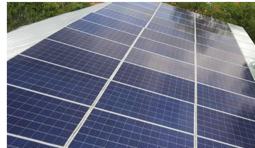
Usina Solar Fotovoltaica
