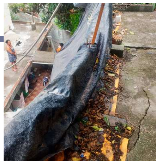
Figura 7. Trinca em muro de contenção de mais de 3 metros. Fonte: LabGRis, 2020.
