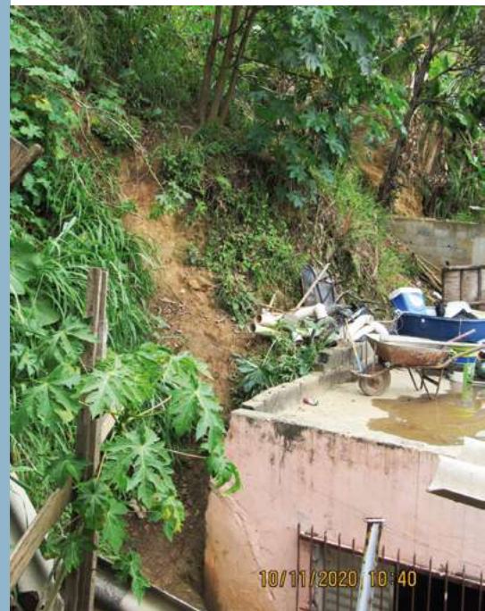
Figura 11. Edificação construída muito próxima do talude, sem área livre para receber o possível material mobilizado. Fonte: LabGRis, 2020.
