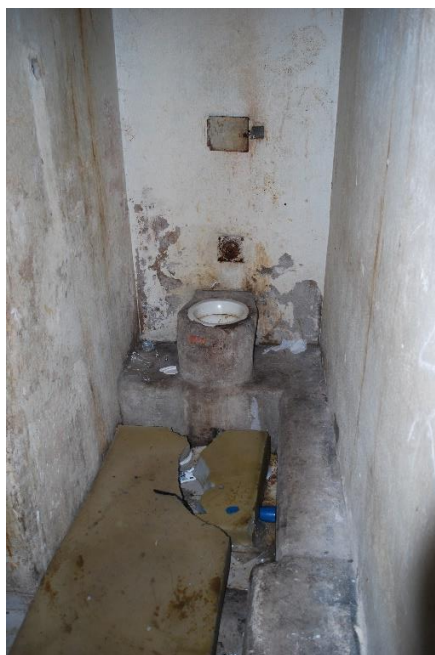
Foto 30: Condições estruturais da penitenciária de São Joaquim de Bicas I. Fonte: MNPCT.
