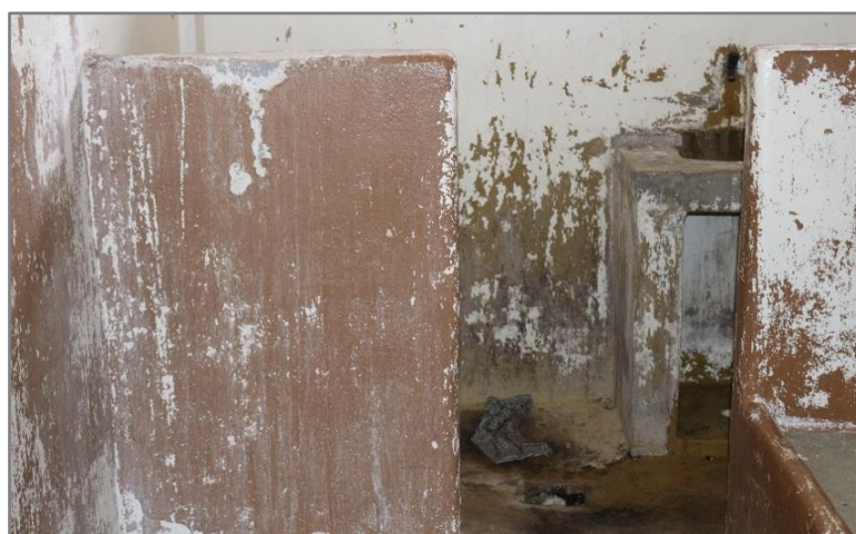
Foto 38: Alojamento de isolamento individual da Unidade feminina em péssimas condições de conservação. Fonte: MNPCT.
