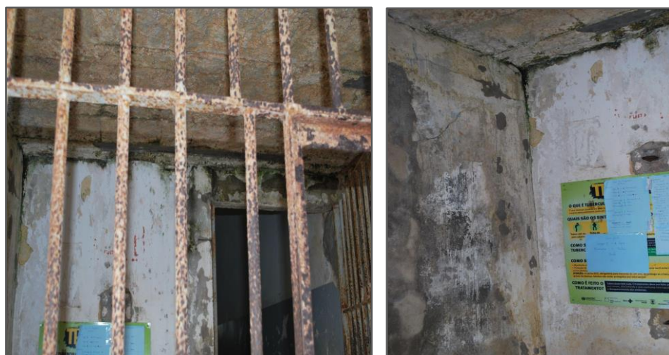
Fotos 63 e 64: Condições estruturais precárias. Fonte: MNPCT
