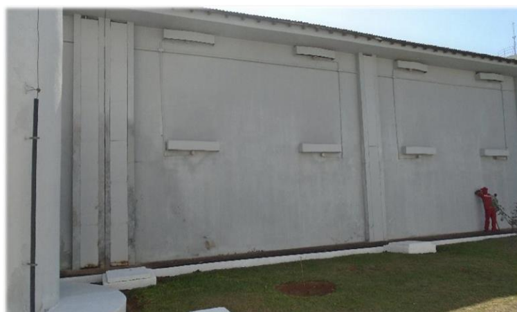
Foto 31: Presídio Jacy de Assis. Ventana das celas tapadas por fora com placas metálicas. Fonte: MNPCT.
