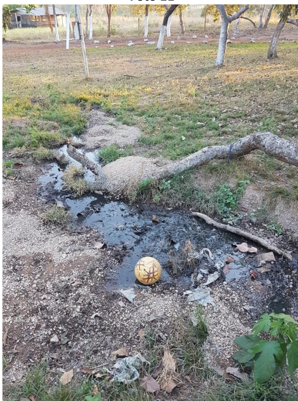
Legenda: Esgoto a céu aberto
