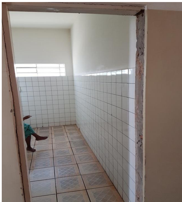
Legenda: banheiro localizado no corredor da ala feminina sem porta
