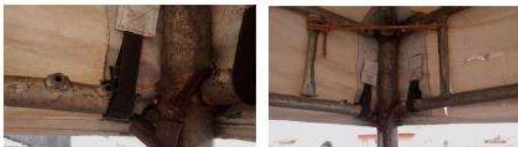
Figura 13 e 14 Estrutura da tenda quebrada e amarrada com corda.
