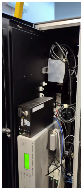
Figura 2 - Parte do sistema de automação e controle
