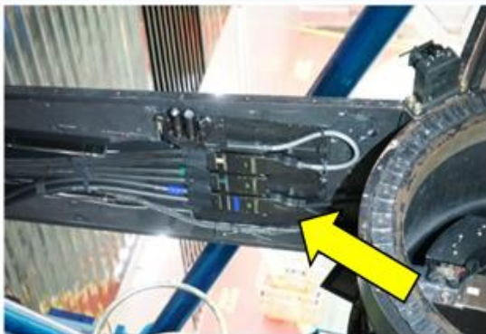
Conectores terminais do cabo já instalados para... conexão com o PFI, quando necessário.
