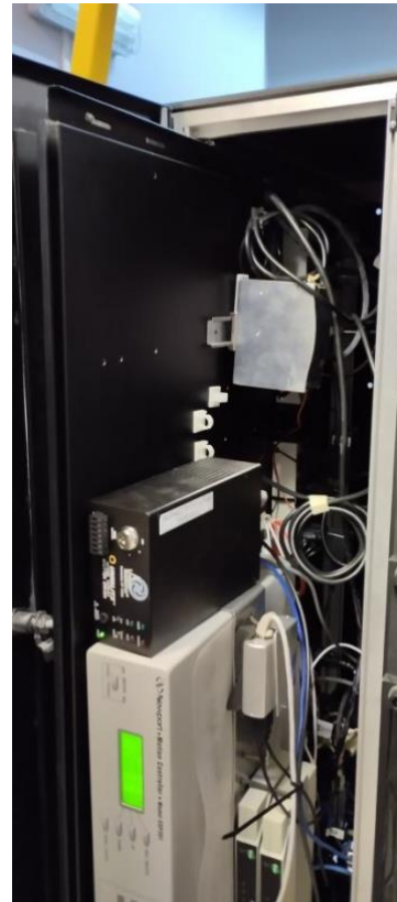
Figura 2 - Parte do sistema de automação e controle
