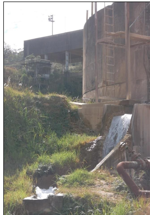
Saída do efluente tratado.
