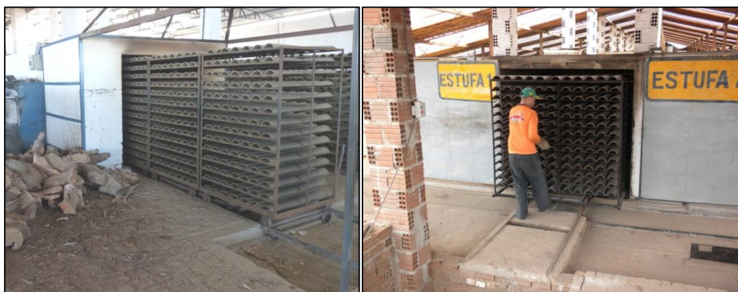
Figura 22 - Secadores tipo túnel alimentados por ar e/ou gases quentes.
