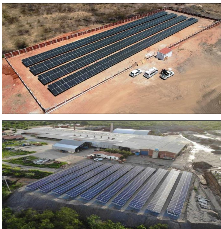
Figura 38 - Plantas solares das Cerâmicas Bela Vista (acima) e Tavares (abaixo).
