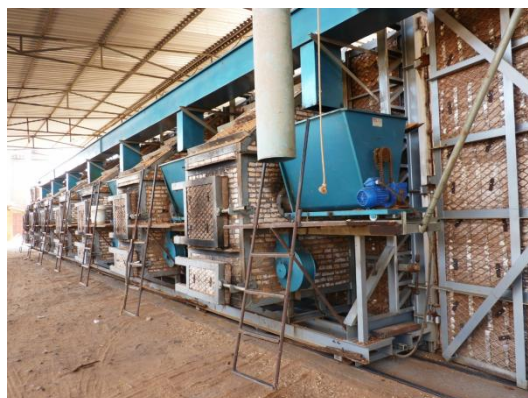
Sistema de alimentação de cavaco/lenha picada em forno móvel.
