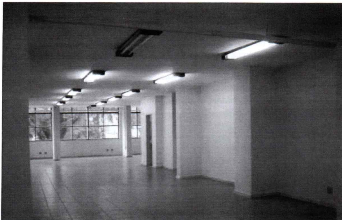
Figura 13: Luminárias e lâmpadas fluorescentes.
