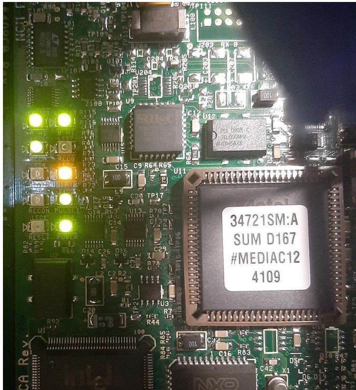
Falha na NCM instalada na JNCA
