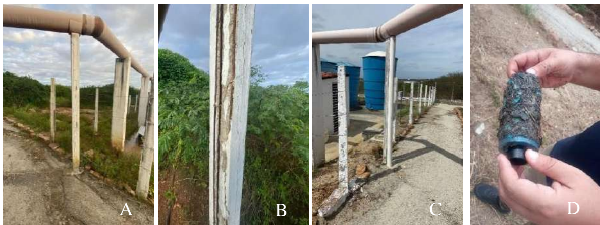
Figura 8. Rachaduras e destacamento de placas nos pilares de sustentação (A-B); Reparos (C); Filtro utilizado no sistema, antes da limpeza (D).
