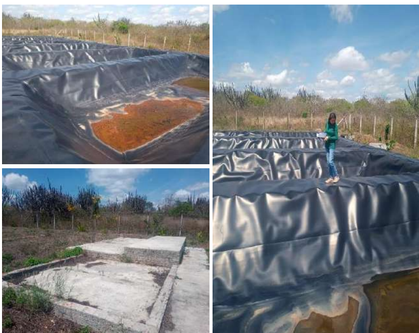
Figura 3. Estação de Tratamento (ETE), EE do INSA. Obra não finalizada no prazo previsto.
