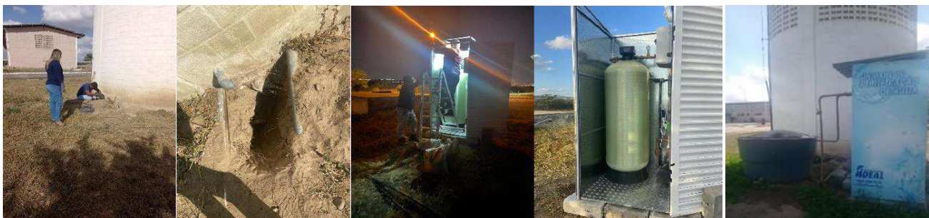
Figura 9. Instalação do Filtro de carvão ativado e Zeólitas no sistema de captação da sede do INSA.
