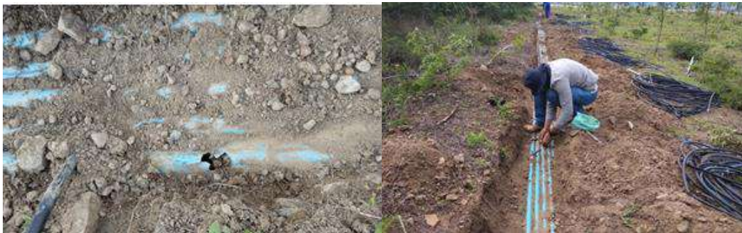
Figura 9. Identificação de obstruções nas linhas principais do sistema de irrigação do reúso de água em espécies florestais na sede do INSA.
