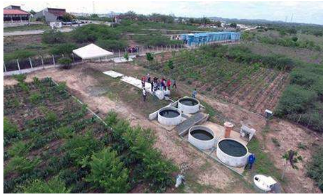
Figura 8. Área experimental e estação de tratamento de esgoto doméstico da sede do Instituto Nacional do Semiárido – INSA.
