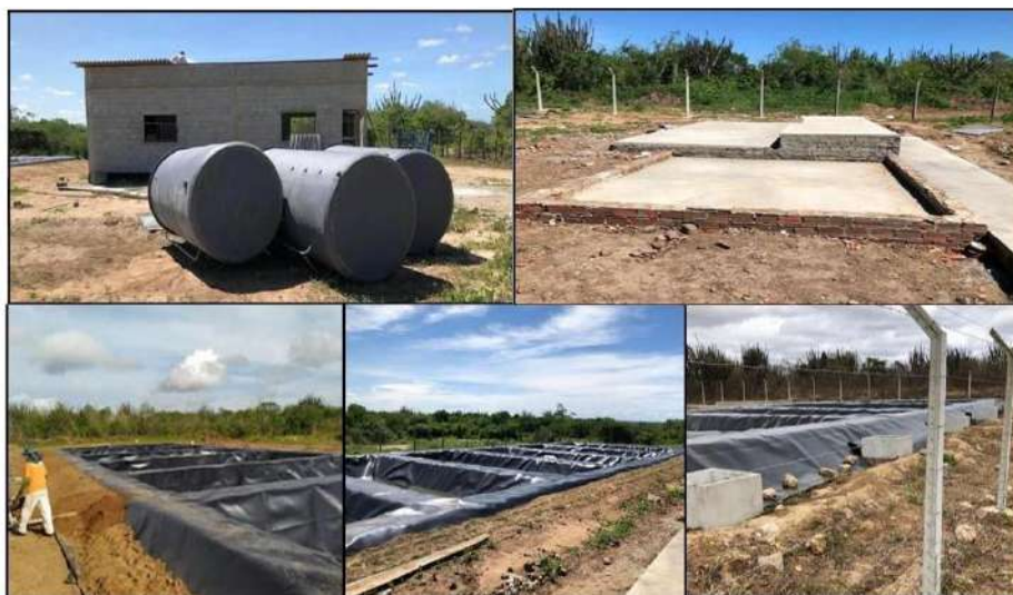
Figura 4. Sistema de tratamento UASBs e Lagoas de polimento
