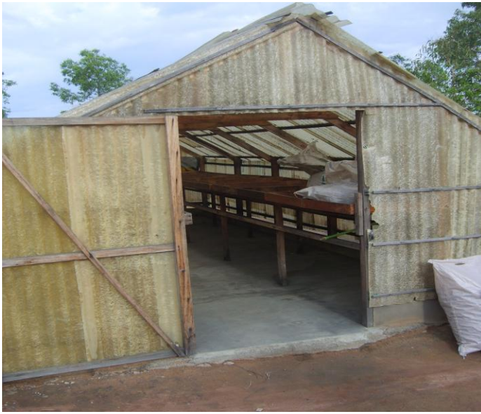
Foto 02: Depósito intermediário de material acabado
