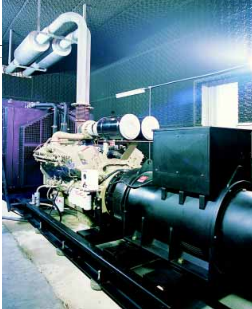
O gerador adquirido pelo Inmetro tem capacidade nominal de 1,2MW
