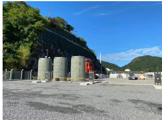
Figura 13: UAS com módulos de armazenamento Fonte: ELETRONUCLEAR (2022)
