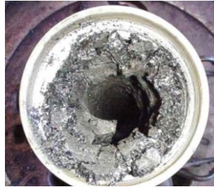
Figura 2.16: Obstrução parcial de duto ocasionada pela deposição de parafinas [Ducke, 2015].
