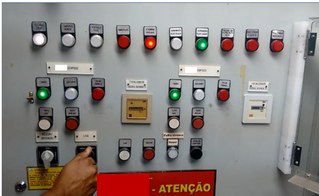
Figura 10: Painel de comando local - comutação manual bomba 1 para bomba 2
