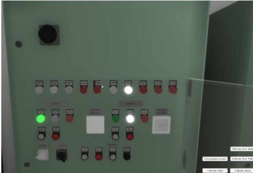
Figura 35: Reprodução dos painéis de comando para as bombas de óleo lubrificante no ambiente virtual
