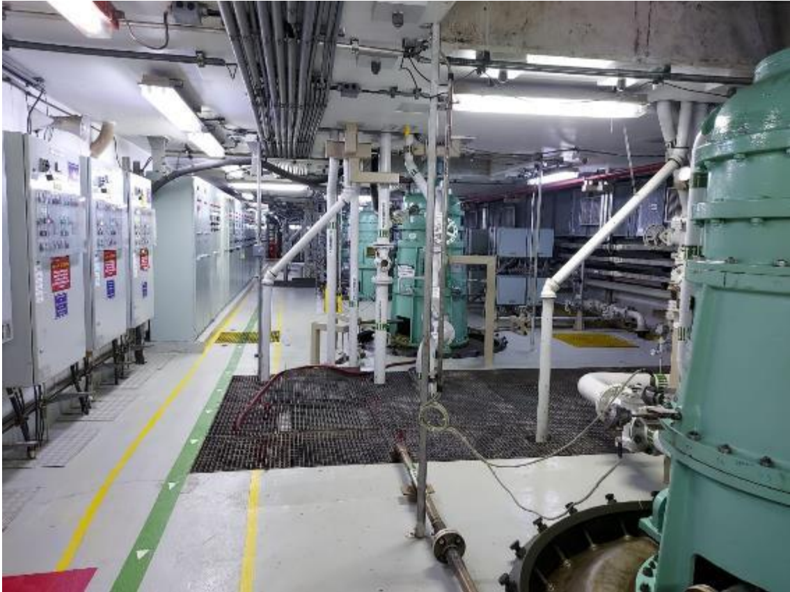
Figura 2: Sistema de Água de Refrigeração Principal – Sala das Bombas
