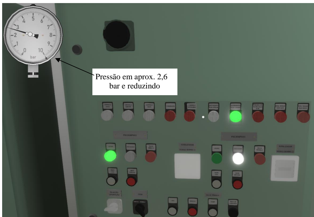
Figura 40: Bomba 1 ligada. Baixa eficiência em andamento. Pressão do manômetro reduzindo e chegando em aprox. 2,6 bar. Sinalização de bomba 1 ligada e bomba 2 desligada, chave seletora Q4 posição para bomba 1
