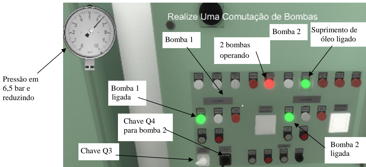
Figura 48: Comutação manual em andamento. Chave seletora Q4 comutada para posição bomba 2. Sinalização acesa de bomba 1 e 2 ligadas. Sinalização acesa de 2 bombas operando. Sinalização de falha apagada. Pressão do manômetro em 6,5bar e reduzindo
