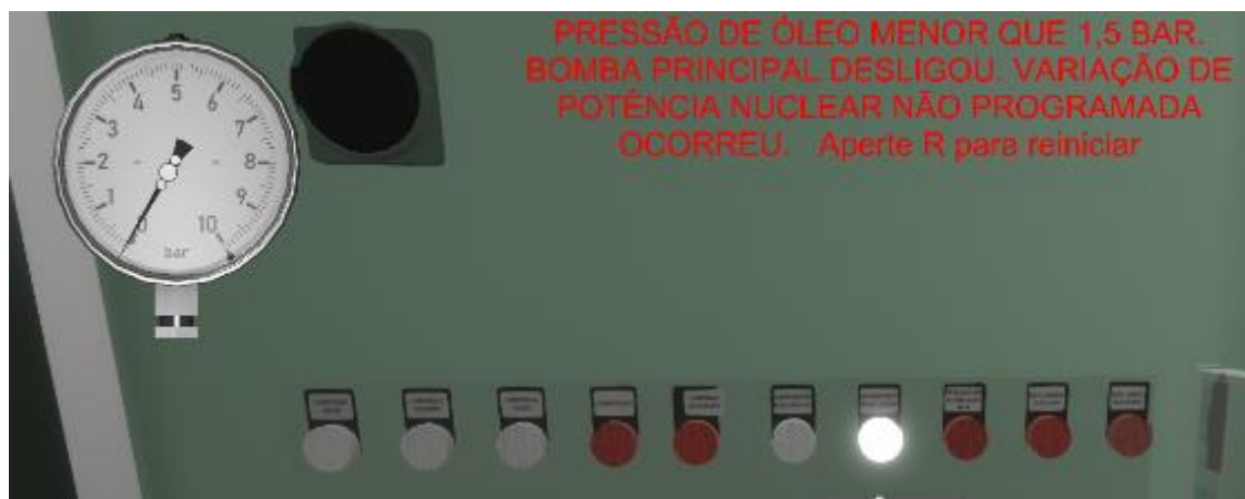
Figura 50: Mensagem de falha total do sistema de óleo da Bomba Principal.
