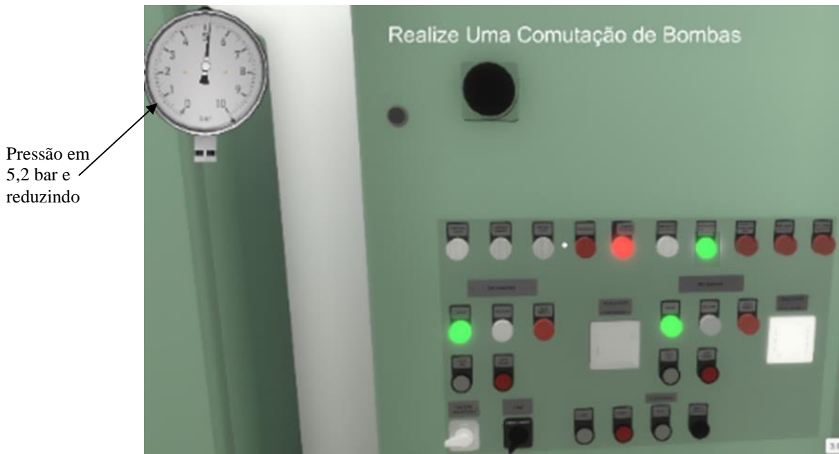
Figura 49: Comutação manual em andamento. Chave seletora Q4 continua comutada para posição bomba 2. Sinalização acesa de bomba 1 e 2 ligadas. Sinalização acesa de 2 bombas operando. Sinalização de falha apagada. Pressão do manômetro em 5,2bar e reduzindo.
