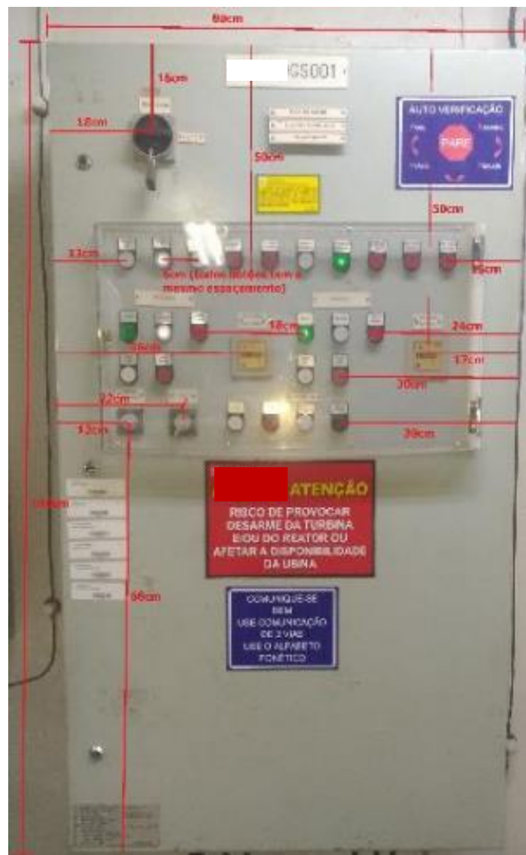
Figura 9: Painel de comando local
