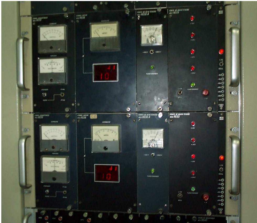
Fig. 13: Canais de potência (Medidor de corrente logarítmico, medidor de corrente linear, fonte de alta tensão, fonte de baixa tensão)
