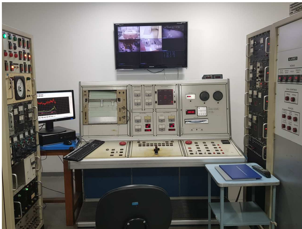
Fig. 20: Sala de controle
