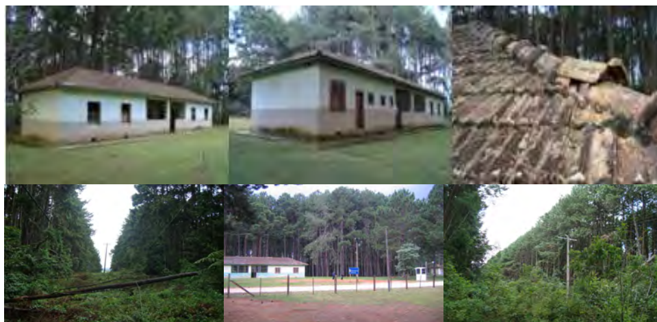
Figura 23 - Riscos à infraestrutura da Flona, causados por árvores de Pinus nos talhões.
