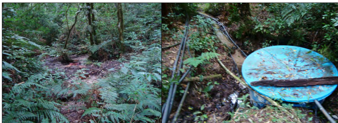
Figura 12 - Nascente e estruturas de distribuição de água localizada na Flona de Pirai do Sul. Autor: BARROS, K. F. (2014)
